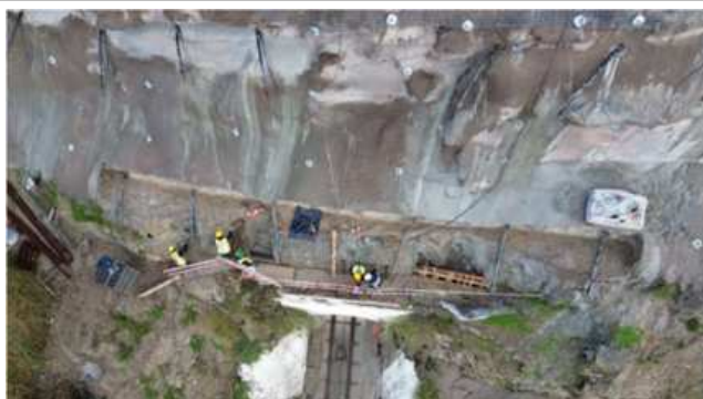
Plataforma Superior do Ascensor – Trabalhos preparatórios para a execução da cofragem da viga inferior;
