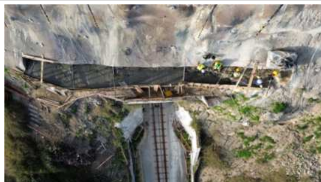
Frente de obra da plataforma Superior do Ascensor – Trabalhos preparatórios para a execução da cofragem da viga inferior;
