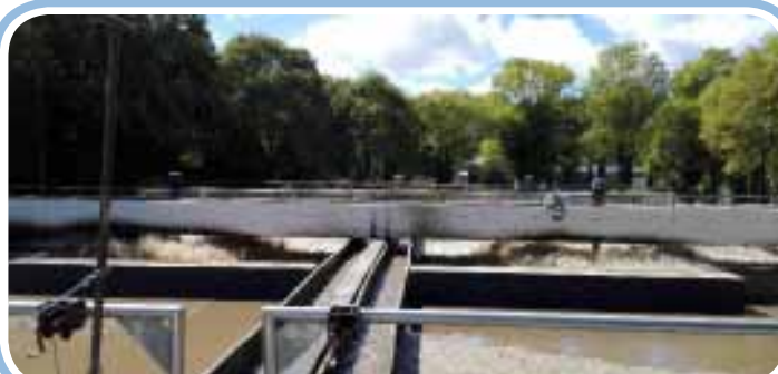
Foto 3 – Tanques de arejamento de ETAR, no concelho de Paços de Ferreira
