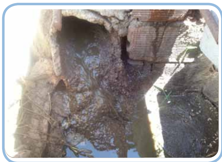
Foto 6 – Descarga de efluente pecuário na linha de água
