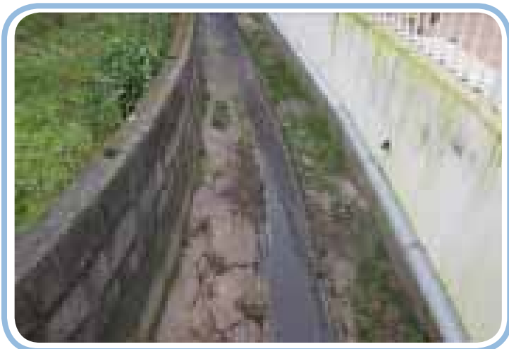
Foto 4 – linha de água objeto de descargas não autorizadas de efluentes
