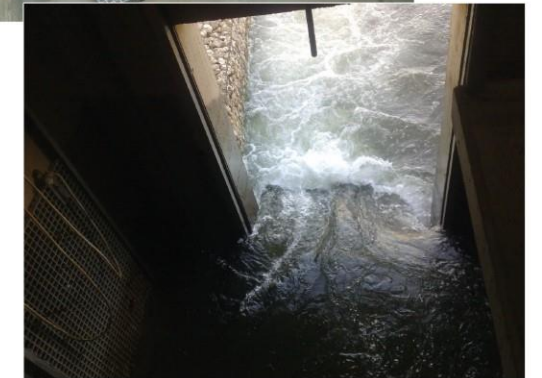
MOTOR E COMPORTA DE JUSANTE
