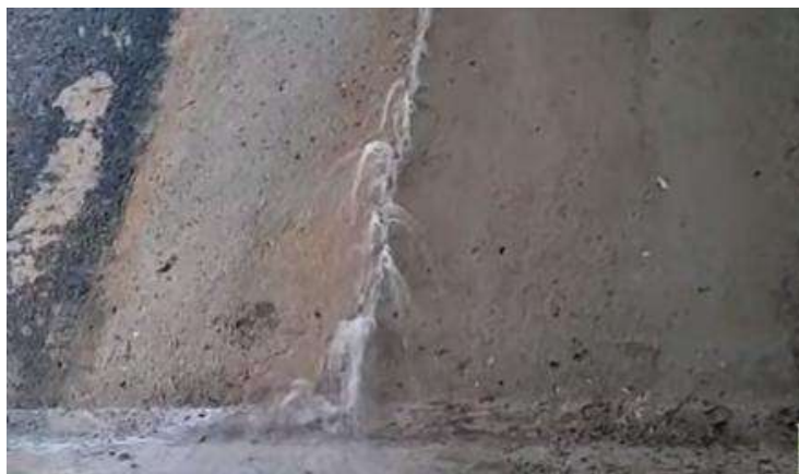
Figura 4.17 – Fluxos de água nas juntas do canal sob a A1 na margem esquerda
