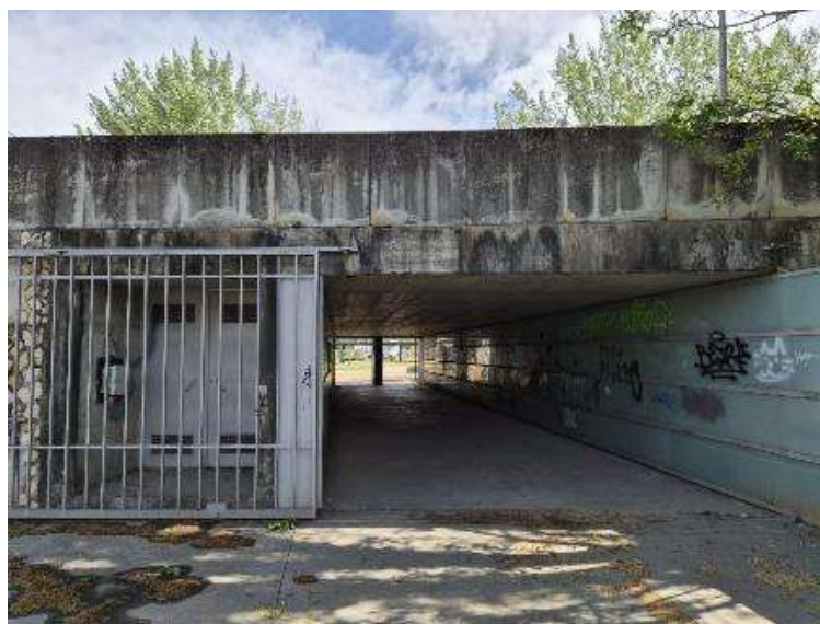
Figura 4.8 – Passagem sob a Av. Inês de Castro (vista ponte – nascente), vendo-se, ao fundo, o Choupalinho (à mesma cota)
