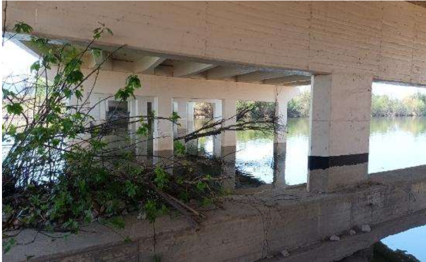
Figura 4.20 – Detritos acumulados nos pilares da ponte após cheia.
