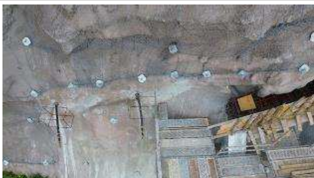
Plataforma Superior do Ascensor – Montagem da cofragem e armaduras para a viga superior;
