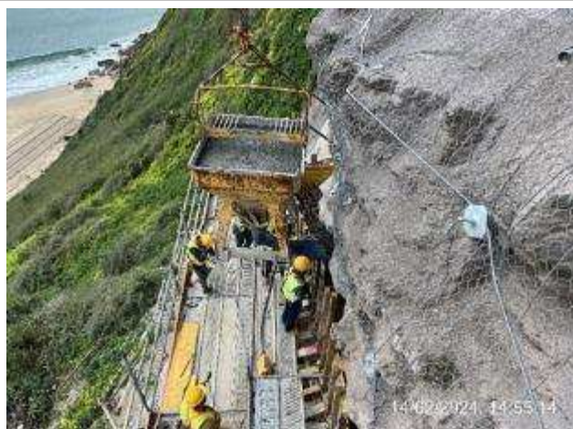
Frente de obra da plataforma Superior do Ascensor – Betonagem da primeira fase da viga superior;
