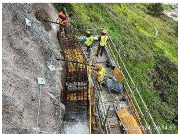
Frente de obra da plataforma Superior do Ascensor – Montagem da cofragem e armaduras para a viga superior;
