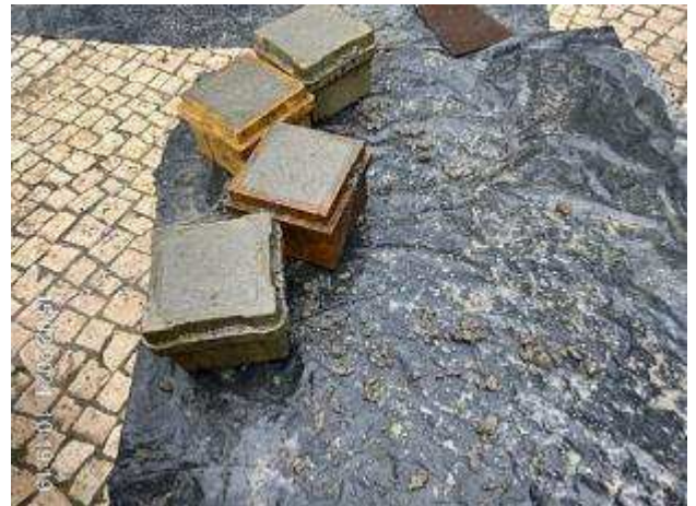
Frente de obra da plataforma Superior do Ascensor – 4 Provetes para ensaio à compressão - 14/02/2024 - GR P518/0085416
