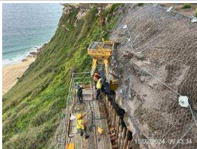
Frente de obra da plataforma Superior do Ascensor – Betonagem da segunda fase da viga superior
