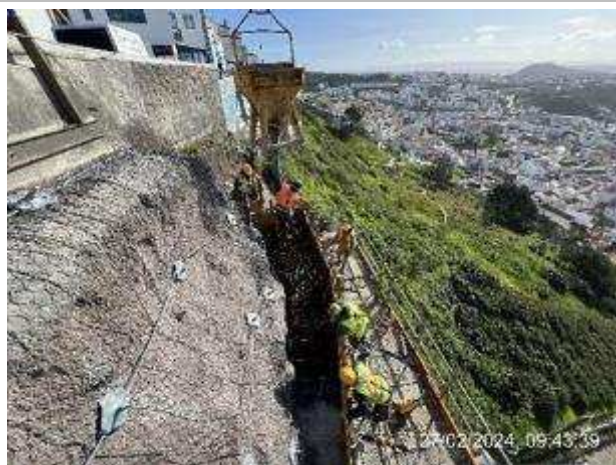
Frente de obra da plataforma Superior do Ascensor – Betonagem da terceira fase da viga superior;
