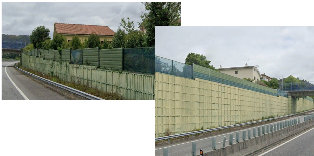
Figura 4-1 – Exemplos de barreiras acústicas de diversos tipos instaladas na A27
