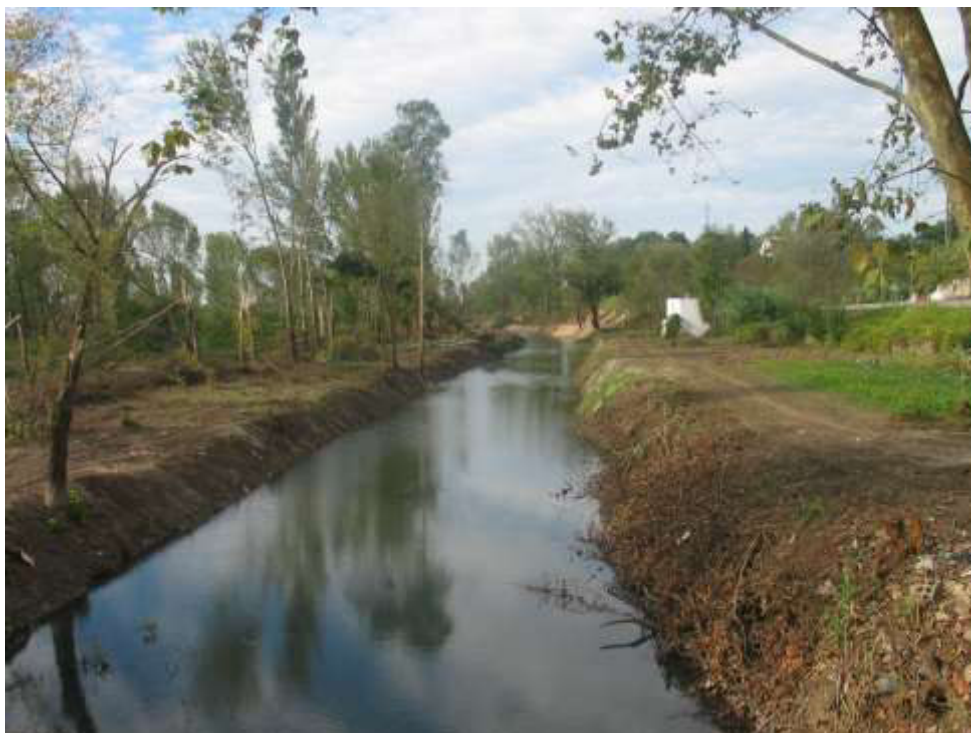
Aspetto da destruição provocada pelo furacão ocorrido em 13 de Outubro Árvores derrubadas e cortadas no leito maior a montante de S. João do Campo em zona já anteriormente intervencionada Vista para jusante
