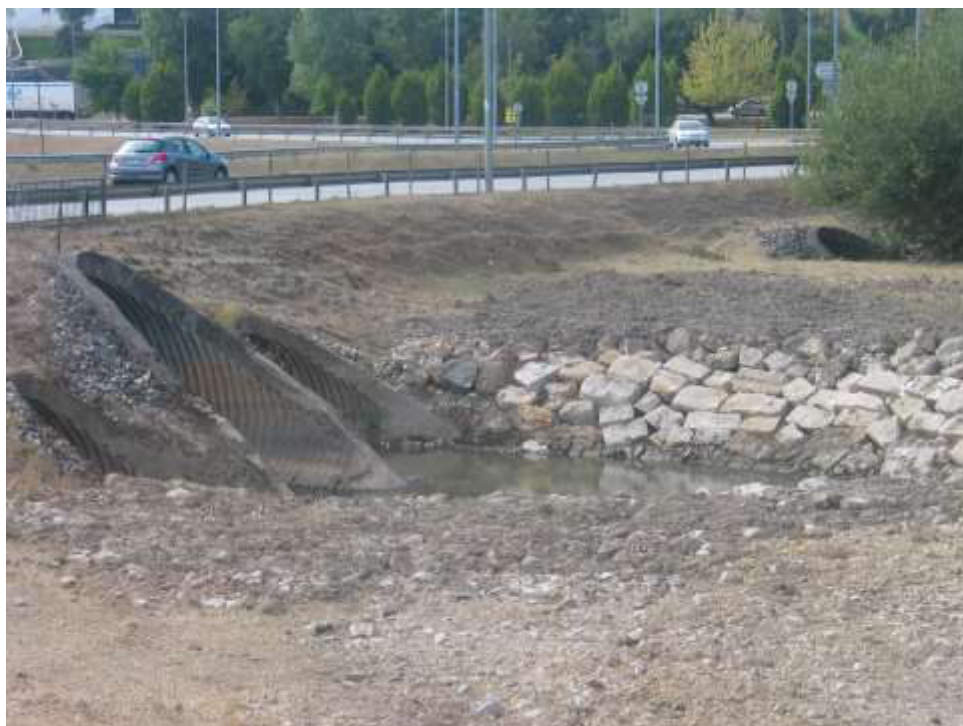
Revestimento de protecção do talude da margem direita a montante da passagem hidráulica da travessia da Cidreira
