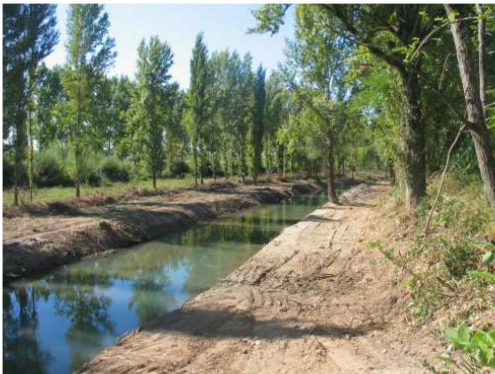
Limpeza de vegetação e desassoreamento do leito menor concluídos entre a travessia de S. João do Campo e a travessia da Cioga
