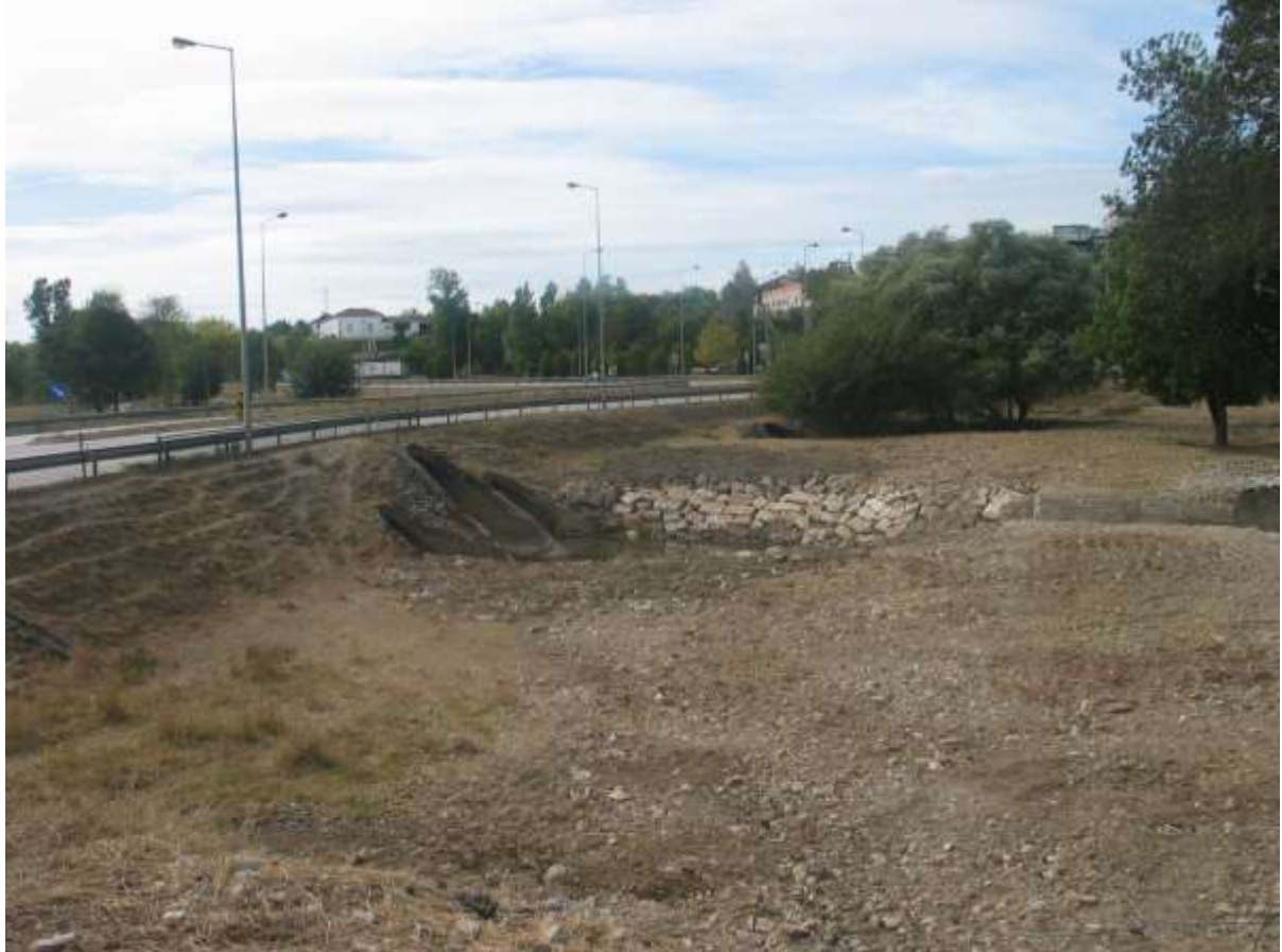
Demolição do pontão e revestimento de protecção do talude do leito menor a montante da travessia da Cidreira concluídos
