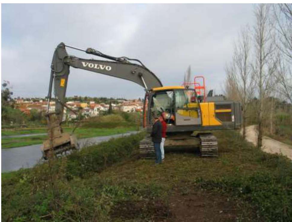
Limpeza de vegetação no dique entre as travessias de Quimbres e de S. Martinho de Árvore
