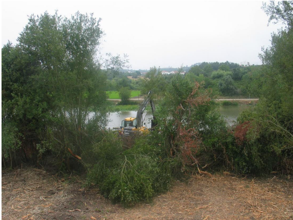
Limpeza de vegetação da plataforma do leito maior na zona do Poço da Cal
