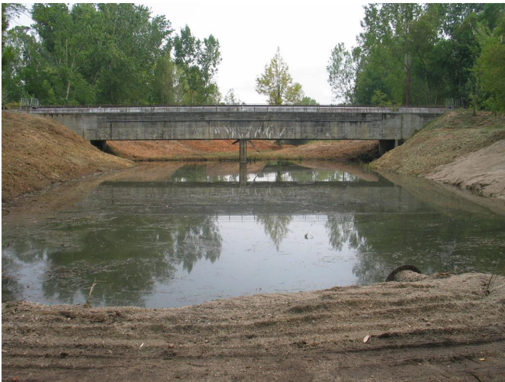
Limpeza de vegetação do Valeiro do Campeão, a jusante da ponte canal concluída
