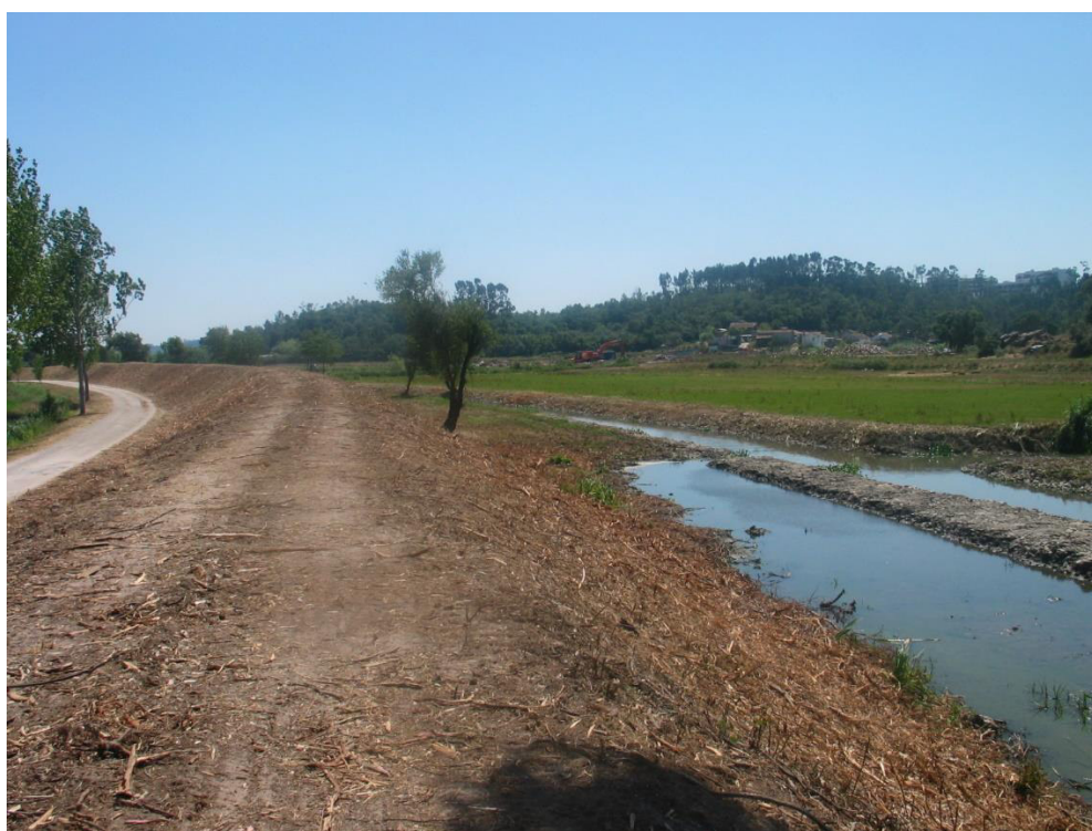
Limpeza de vegetação e desassoreamento concluídos entre as travessias das Meãs e de Lavariz – Vista para jusante
