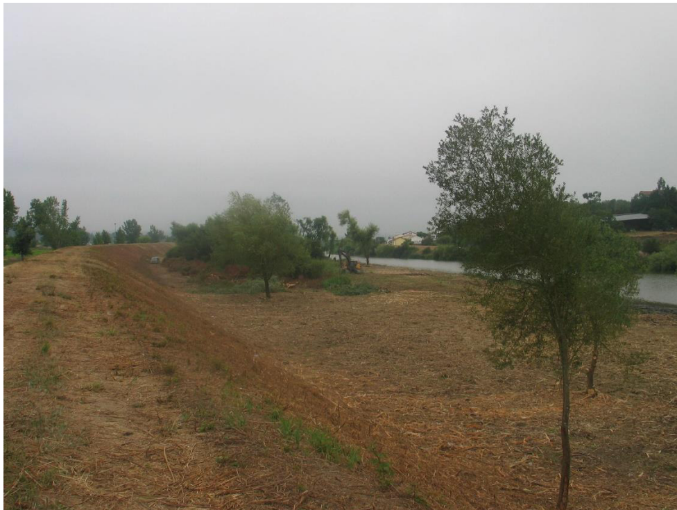
Limpeza de vegetação do dique e do leito maior na zona do Poço da Cal Fase final. Vista para jusante
