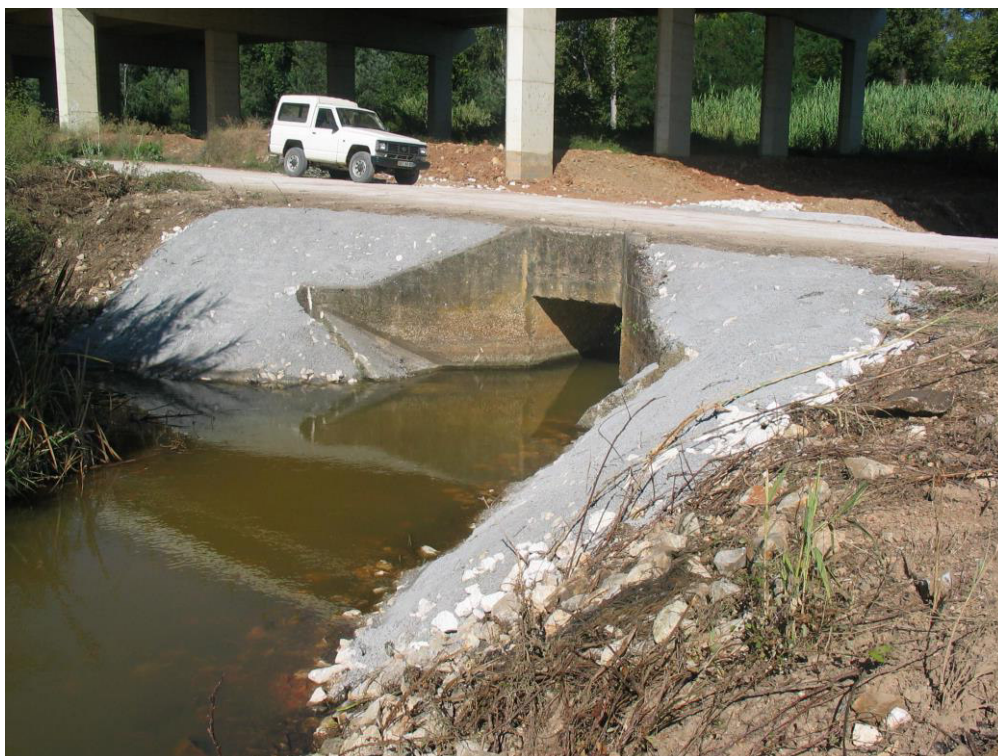
Reabilitação da passagem hidráulica do Rio Velho junto ao viaduto da A1 concluída Vista da estrutura de montante
