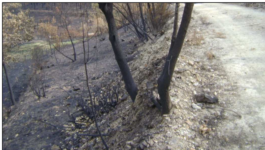
Figura 24 – Freguesia da Erada- Caminhos Florestais(taludes fragilizados)
