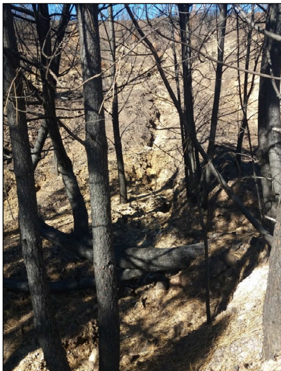
Figura 117 – Recuperação da seção de vazão de passagens hidráulicas – Necessidade de limpeza, desassoreamento e colocação de barreiras naturais
