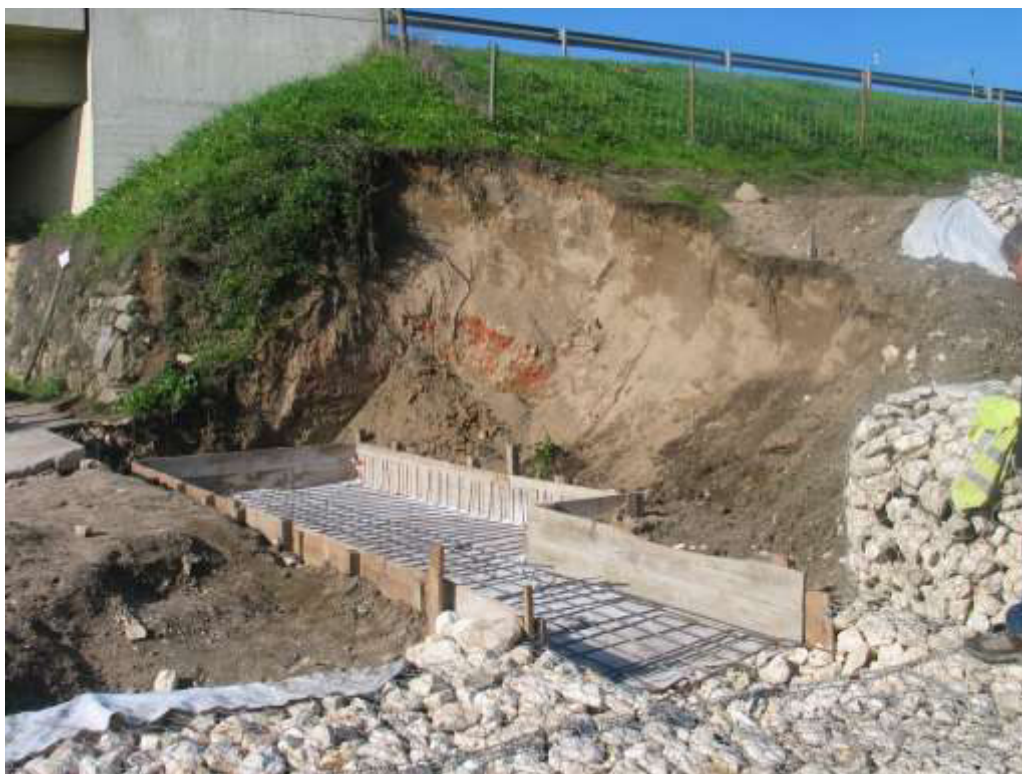
Estrutura de dissipação de energia do descarregador ECC 3 Início da montagem do ferro da sapata do muro de suporte
