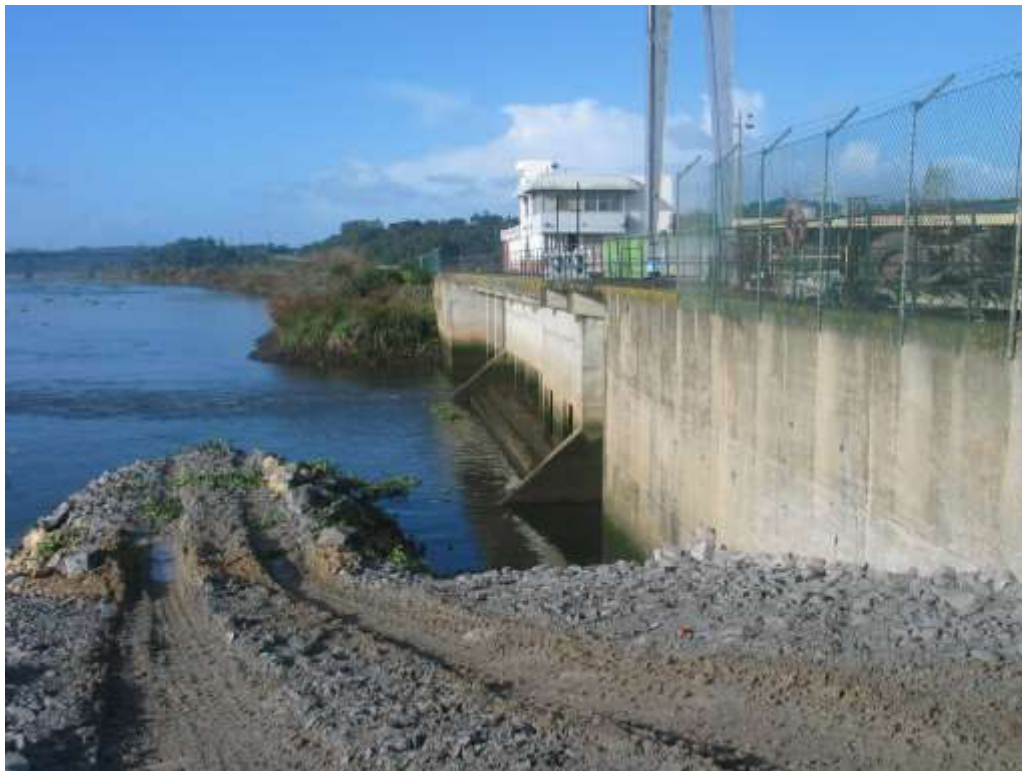
Consolidação da fundação a jusante da estação elevatória do Foja Aterro de acesso e colocação no leito de mistura de enrocamento e tout-venant
