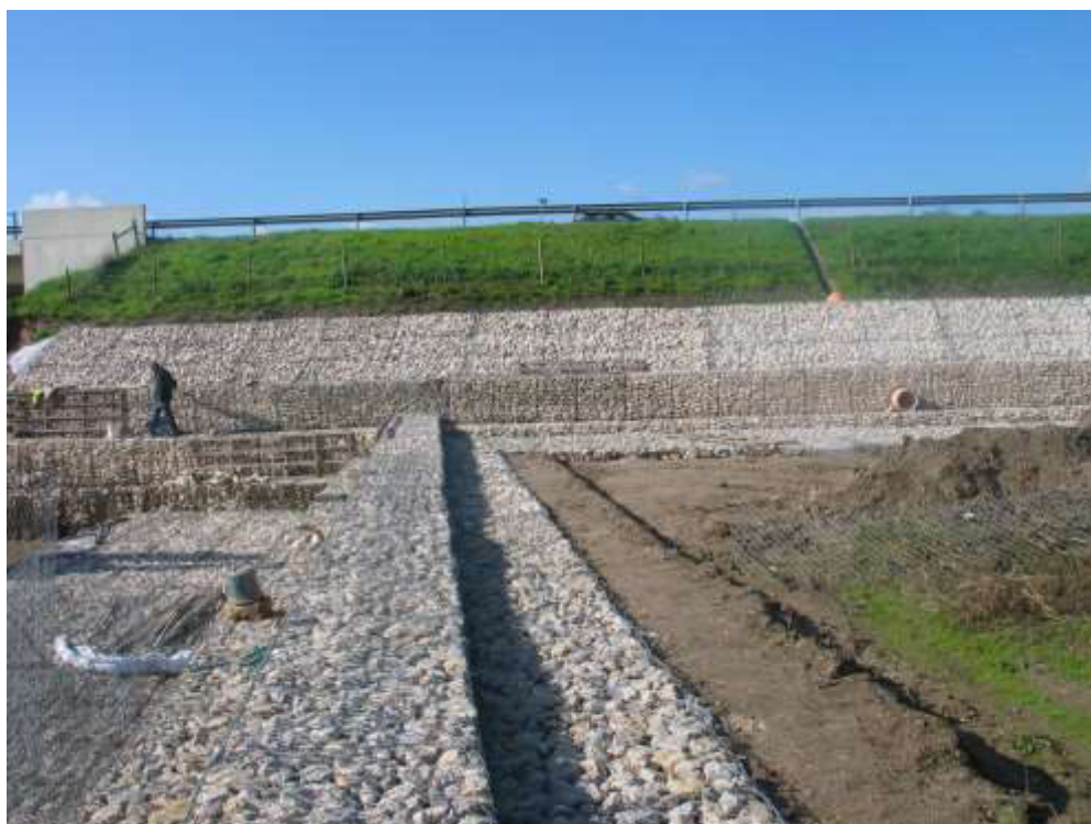
Estrutura de dissipação de energia do descarregador ECC 3 Colchão Reno de proteção do talude da A1 concluído
