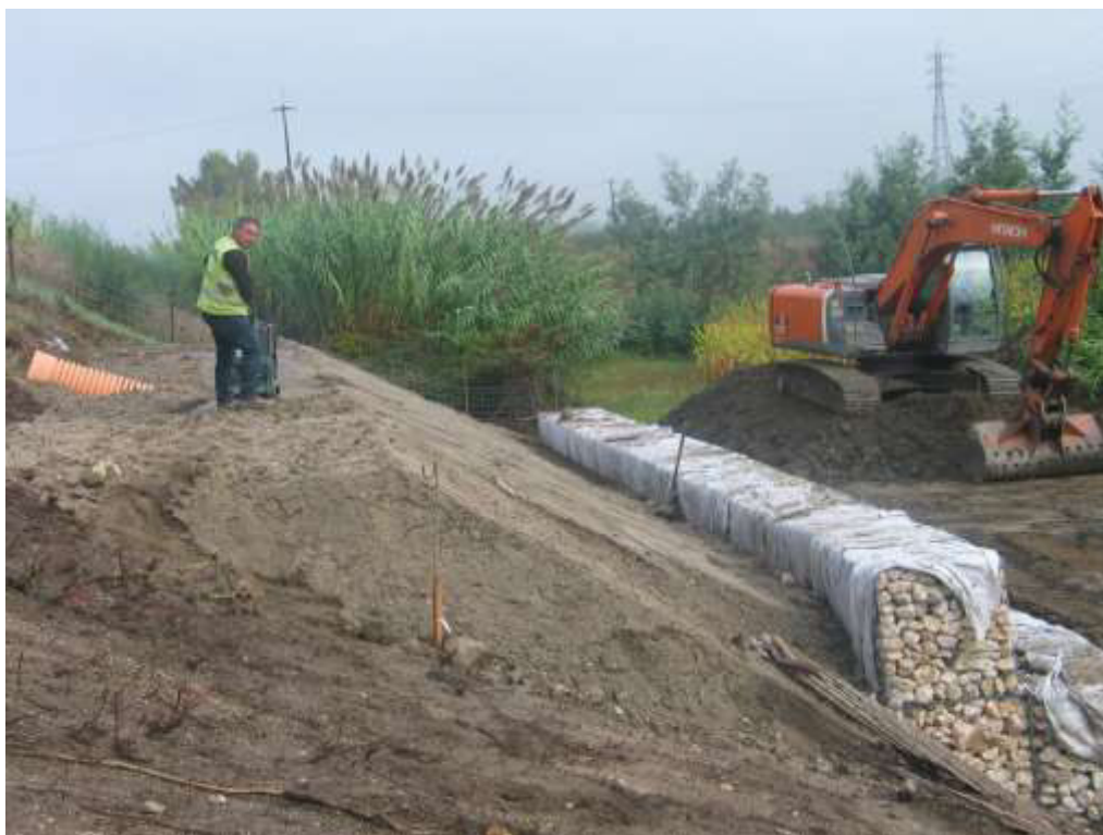
Estrutura de dissipação de energia do descarregador ECC 3 Aterro do talude da A1 e gabião de suporte
