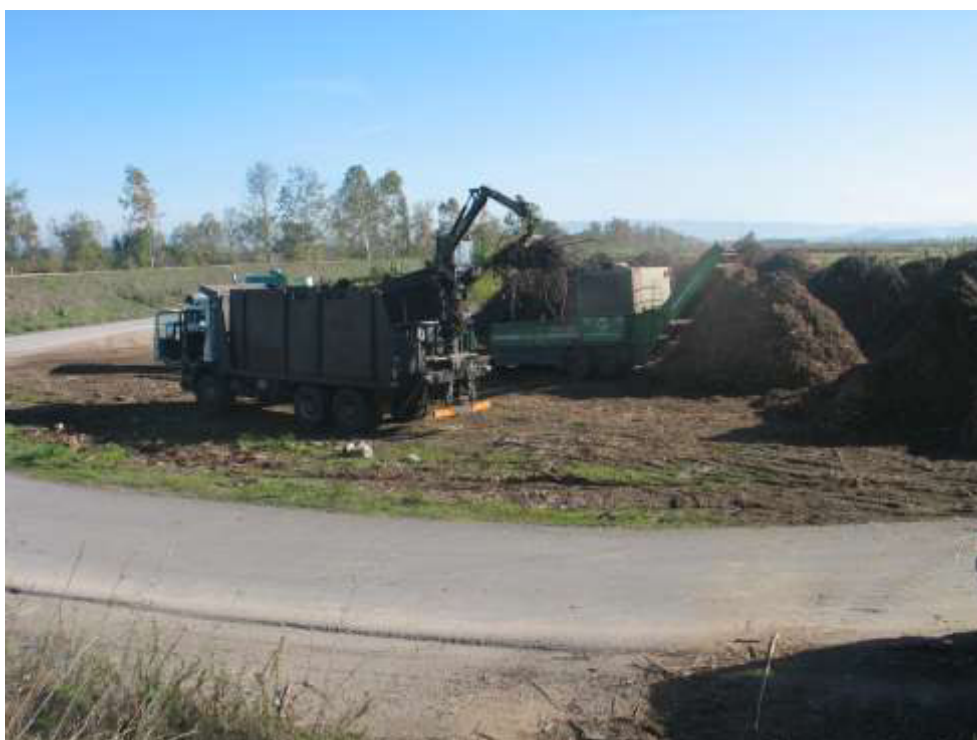
Destroçamento da vegetação na margem esquerda junto à confluência do Leito Periférico Esquerdo
