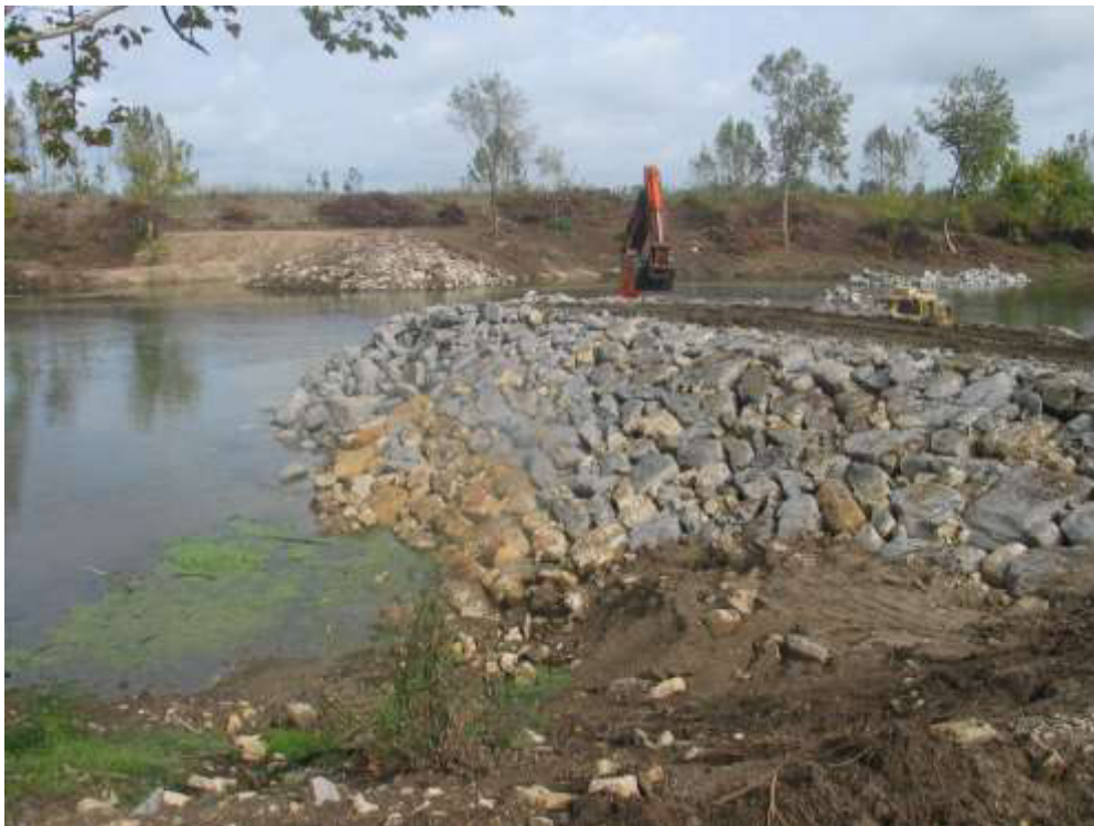
Reabilitação da soleira do perfil 115 do Leito Central do rio Mondego Talude de jusante do esporão regularizado
