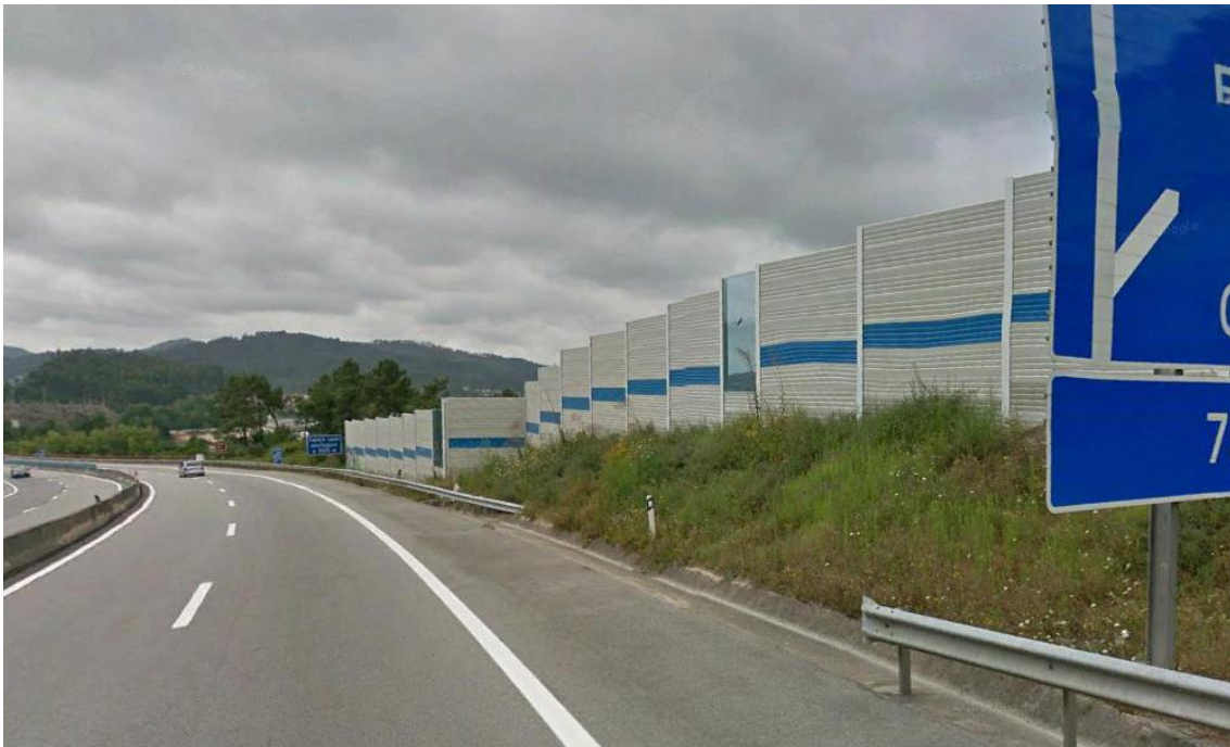
Imagem 2: Barreira Metálica e acrílica
