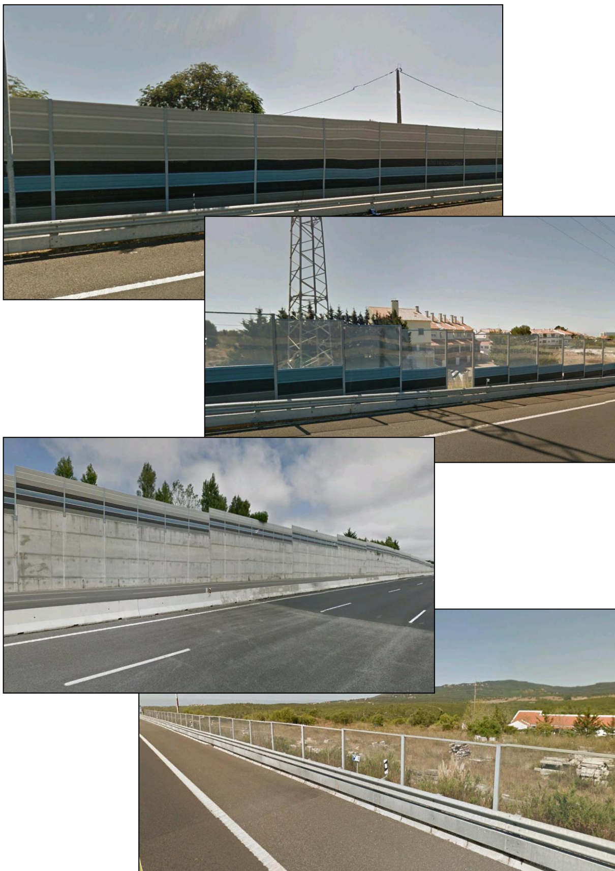
Figura 4-3 – Exemplos de barreiras acústicas de diversos tipos instaladas na A16
