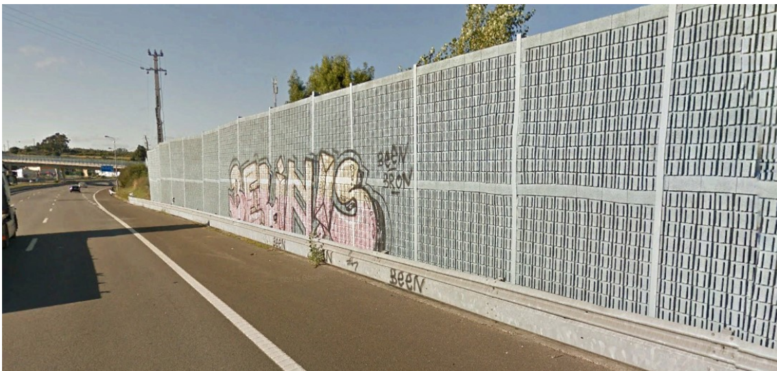
Imagem 3: Barreira de Blocos de alvenaria
