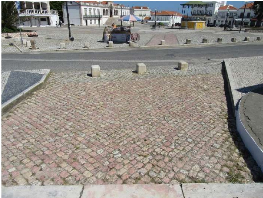
Fot. 25 – É bem visível a ligação do pavimento da capela com o percurso que chega do Largo Nossa Senhora da Nazaré
