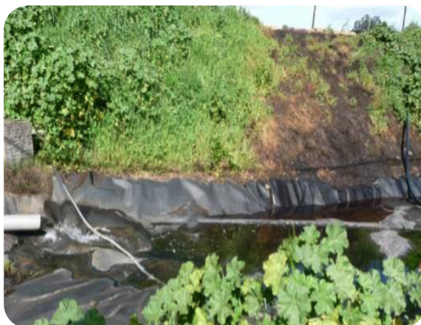
Contaminação das águas de arrefecimento pelas águas ruças, transbordadas da lagoa de armazenamento
