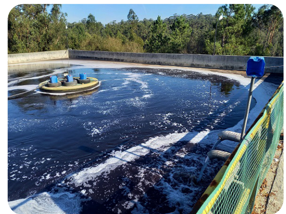
Tanque biológico de ETAR Industrial
