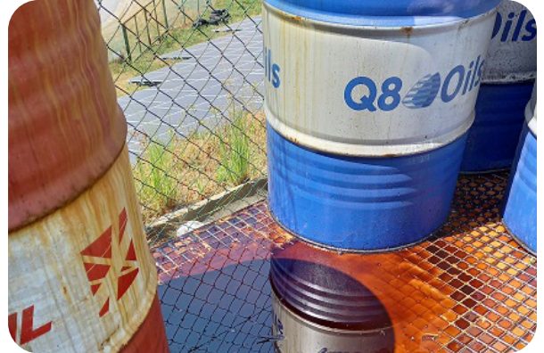
Bacia de retenção de óleos insuficiente, provocando a escorrência de águas pluviais contaminadas para o solo
