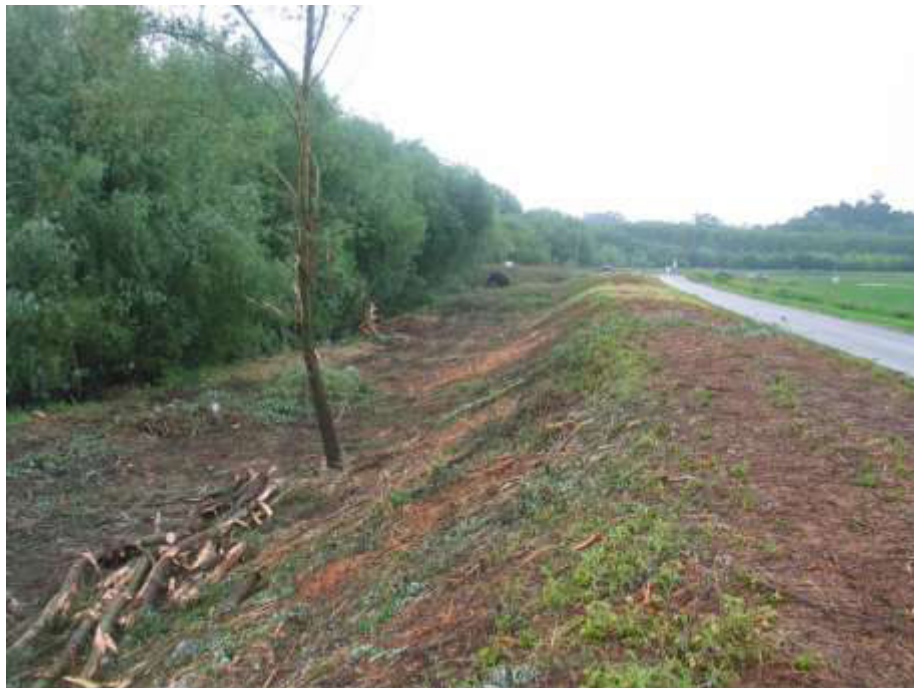
Limpeza de vegetação no dique e leito maior a jusante da travessia da Adémia concluída (Junho 2018)
