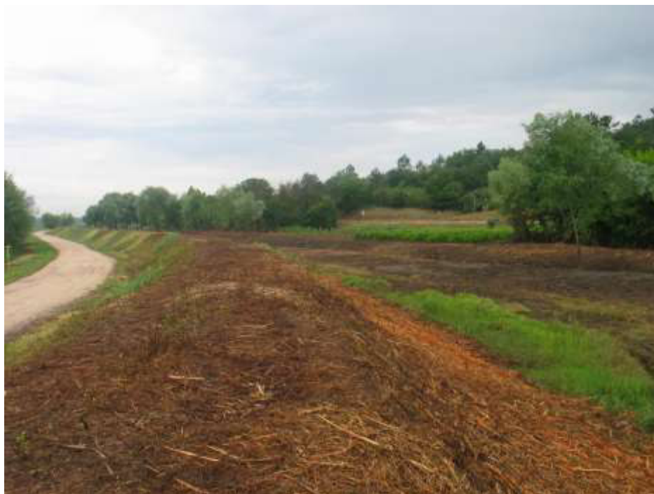
Limpeza de vegetação e desassoreamento no leito na zona entre a Travessia da Adémia e Antuzede Vista de montante para jusante ( Junho 2018 )
