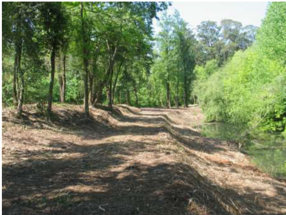
Corte e destroçamento de vegetação no leito na Mata da Geria ( Maio 2018 )
