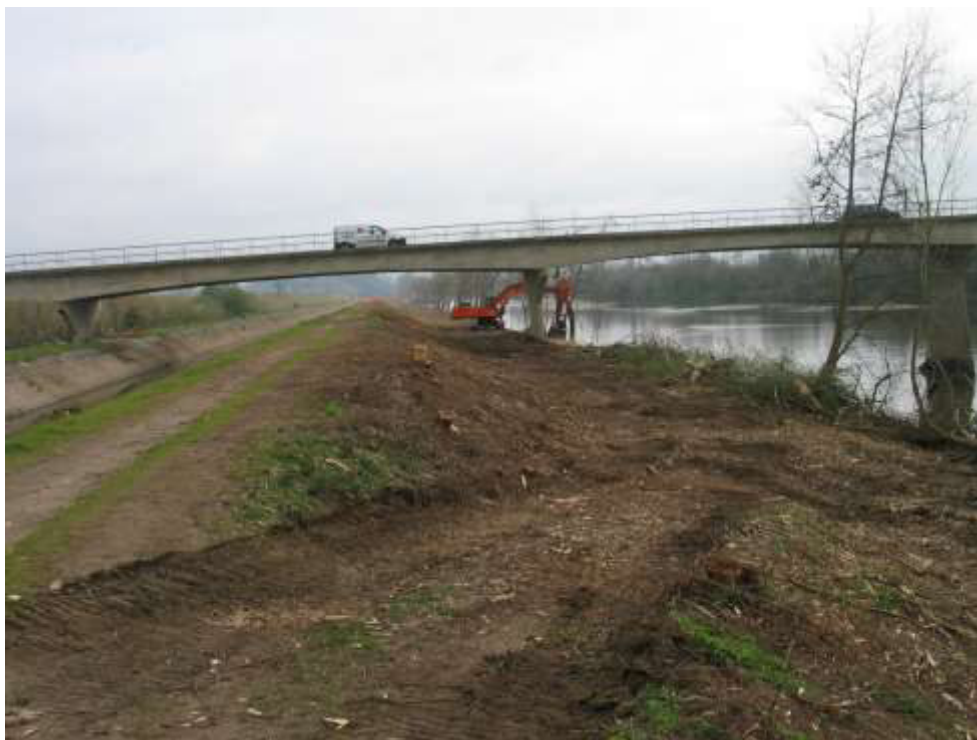
Limpeza de vegetação no talude do leito menor e plataforma do leito maior da margem direita junto ao viaduto da A1
