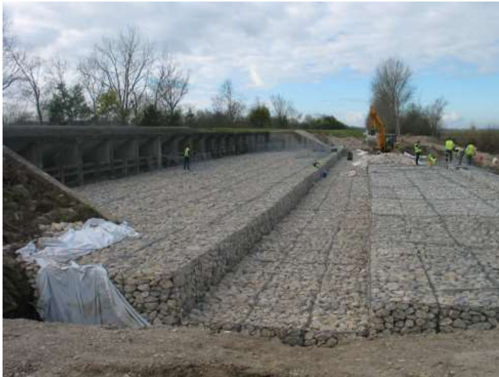
Aspecto da evolução da execução de gabiões na estrutura de dissipação de energia do descarregador ECC2
