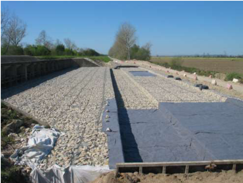
Estrutura de proteção do descarregador de cheias ECC 2 Colocação de geotêxtil sobre os gabiões, para posterior betonagem
