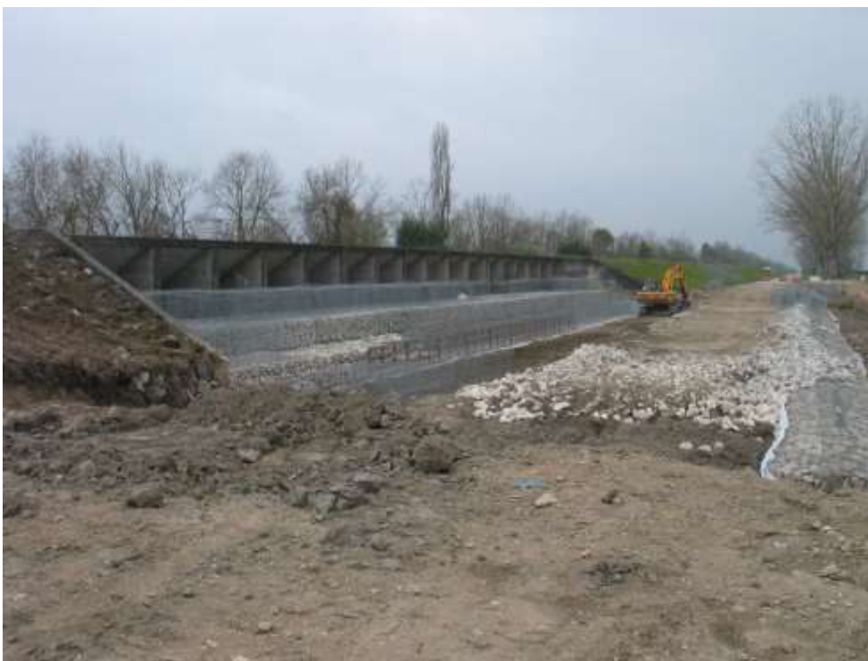
Estrutura de proteção em gabiões do descarregador ECC1 Escavação para modelação de terreno no alinhamento da estrada de manutenção
