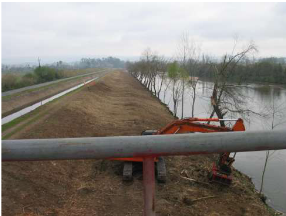
Limpeza de vegetação do dique, gomena e talude do leito menor a montante da ponte de Casais concluída
