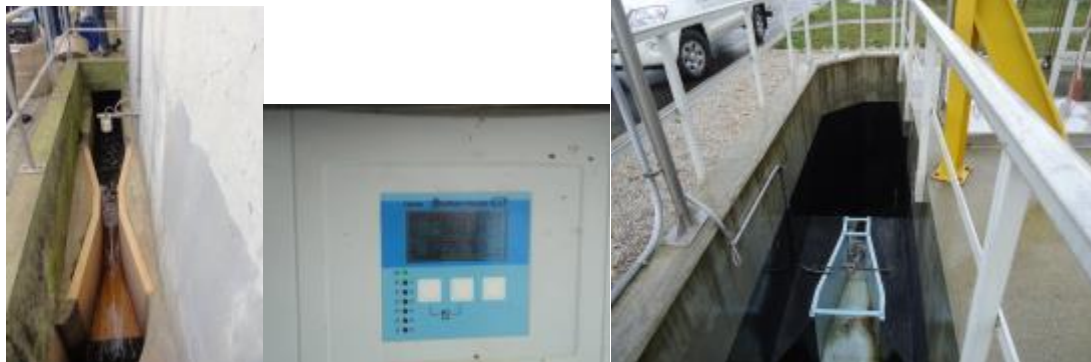
Medidor de caudal de águas residuais, associado a canal Venturi (Fonte: APA, I.P)
