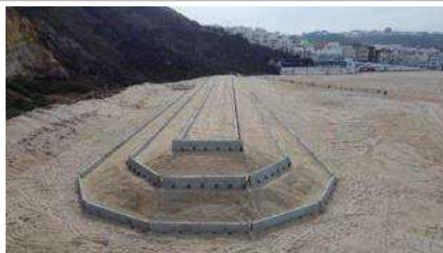
Frente de obra da Duna – Receção Provisória no dia 27 de Julho de 2023;
