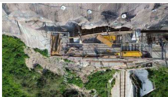
Frente de obra da plataforma Superior do Ascensor – Montagem da cofragem e armaduras para a viga superior;
