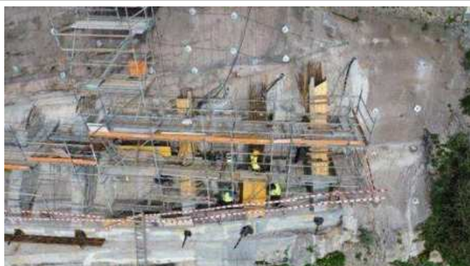
Frente de obra da plataforma Superior do Ascensor – Montagem da cofragem e armaduras para a terceira fase dos montantes;
