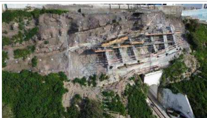
Frente de obra da plataforma Superior do Ascensor – Montagem da cofragem e armaduras para a viga superior;
