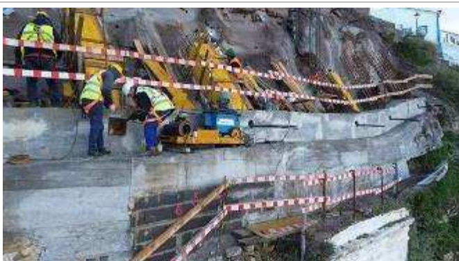
Frente de obra da plataforma Superior do Ascensor – Ensaio de pré-esforço simplificado na ancoragem A2.2
