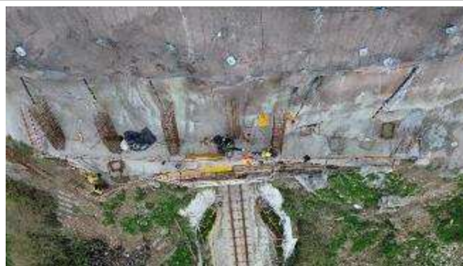
Frente de obra da plataforma Superior do Ascensor – Trabalhos de montagem das armaduras na primeira fase dos montantes;
