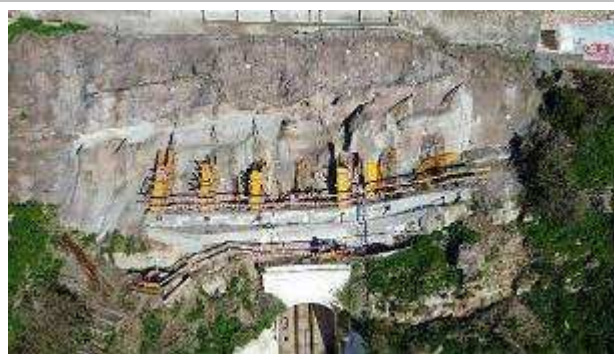
Frente de obra da plataforma Superior do Ascensor – Trabalhos de montagem das armaduras na primeira fase dos montantes;
