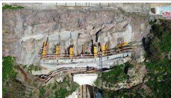
Frente de obra da plataforma Superior do Ascensor – Trabalhos de cofragens na primeira fase dos montantes.
