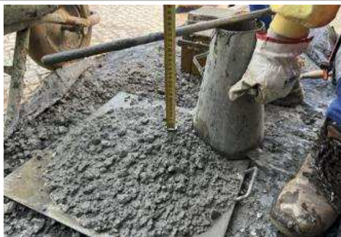
Frente de obra da plataforma Superior do Ascensor – Ensaio de Slump - GR P518/0083971
