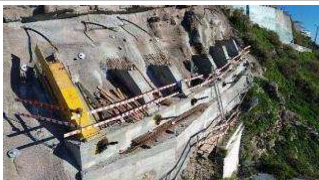
Frente de obra da plataforma Superior do Ascensor – Descofragem da primeira fase dos 6 montantes
