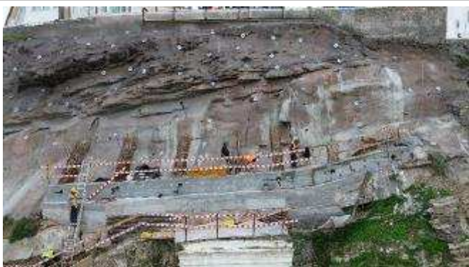
Frente de obra da plataforma Superior do Ascensor – Trabalhos de montagem das armaduras na primeira fase dos montantes;
