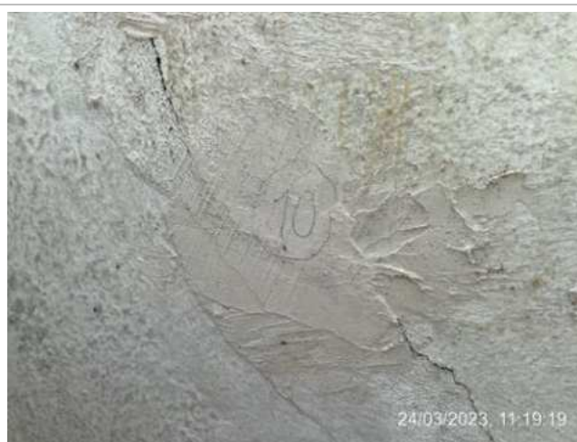
Monitorização de testemunhos em gesso no muro;
