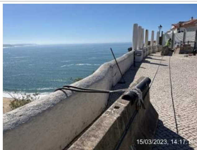
Instalação da linha de vida na Plataforma Superior do Ascensor;
