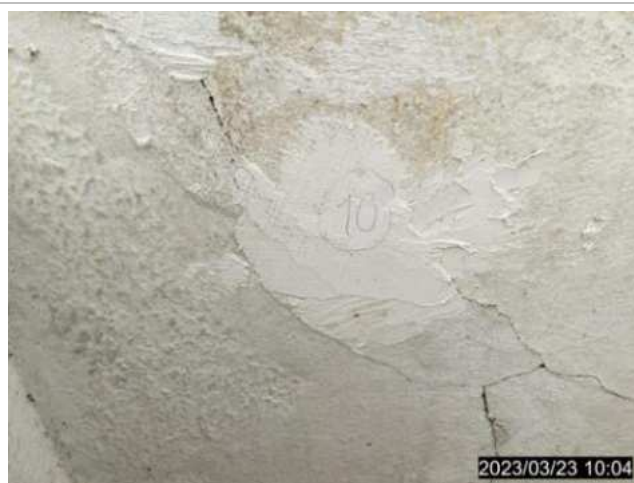
Monitorização de testemunhos em gesso no muro;
