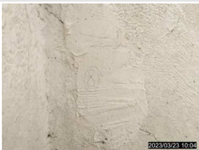
Monitorização de testemunhos em gesso no muro;
