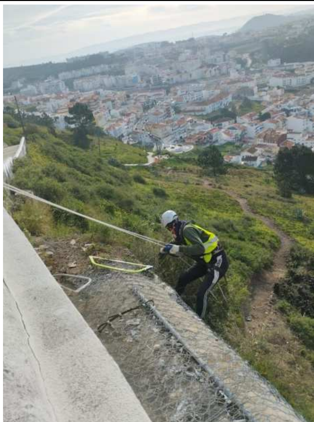
Foto 8 – Limpeza e Desmatação do Pano do Talude com Recurso a Técnicas de Alpinismo
